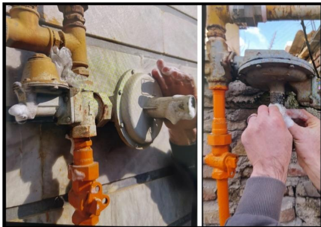
شکل ۱۳. بازدید بصری تست نشت گاز در محل استقرار رگلاتور اصلاح شده
