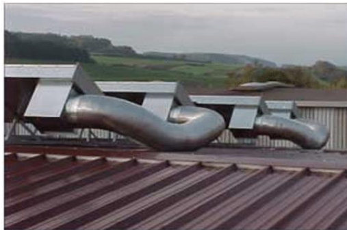
شکل (۱) هواگرمن خورشیدی نصب شده بصورت شیب‌دار در سقف یک کارگاه
