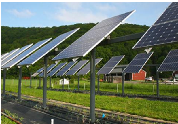
شکل ۳. سیستم احداث شده در شهر امهرست.
