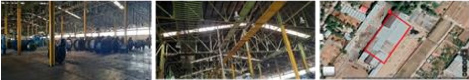
شکل ۲. از راست به چپ: موقعیت مکانی سالن تولید در نقشه‌ی هوایی، نورگیر سقفی سالن تولید، فضای داخلی نمونه مطالعاتی (نویسندگان).
