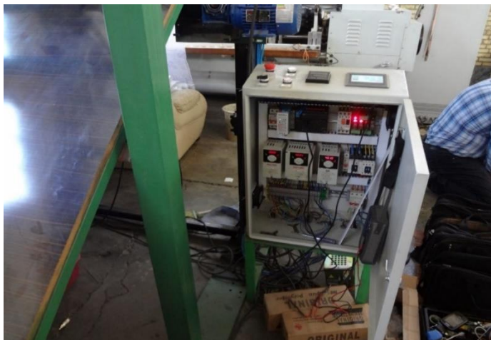
شکل ۱۱. تست تابلو کنترل.
