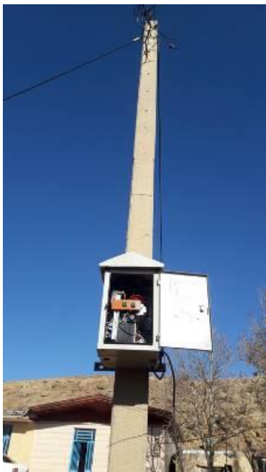
شکل ۱۰. نصب میدانی SSVR نیمه صنعتی \Delta KVA در روستای پایتخت ۳ کاکاشرف خرم آباد.
