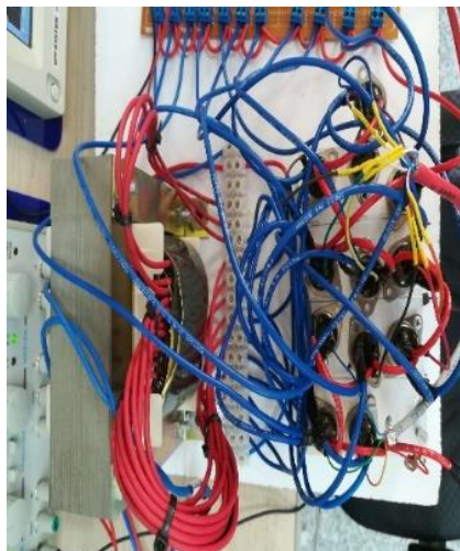
شکل ۱۵. مدار قدرت شامل کلیدها و اتوترانسفورماتور.
